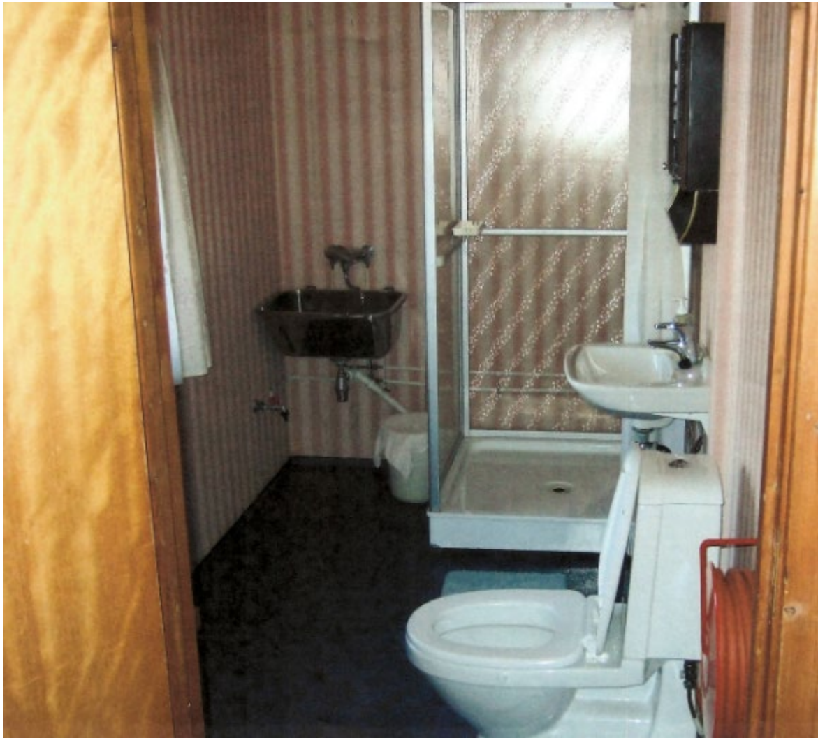
Figur 5 Lite innbydende bad, som trenger totalrenovering
