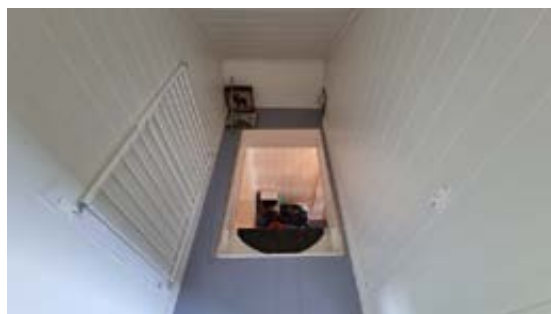
Rekkverk omkring trappehull mangler.
