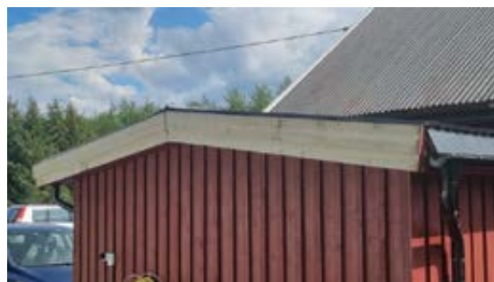
Manglende beslag i overgang tak og vindskibord.
