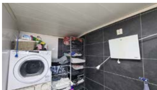
Utbredt bruk av skjøteledninger på badet.
