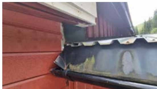
Stedvis utettheter i overgang tilbygget bad og yttervegg.
