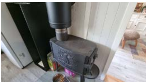
Ildstedet er provisorisk montert og er for nærme veggen/ brennbart materiale.
