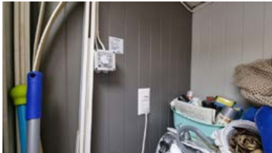
Bryter for vannrør er plassert på teknisk rom.
