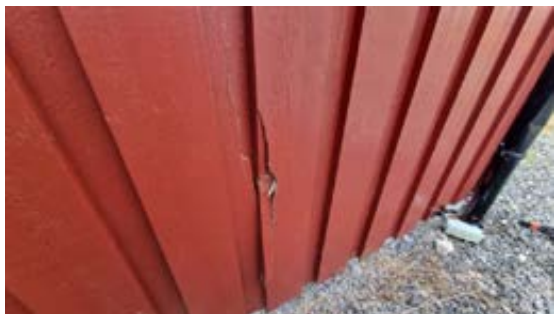
Skade i kledningsbord.
