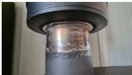
Tape omkring røykrøret må fjernes og røykrøret må monteres forskriftsmessig.
