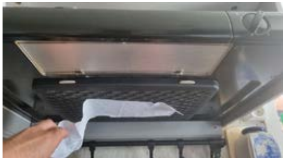
Funksjonstesting av det mekaniske avtrekket over koketoppen.
