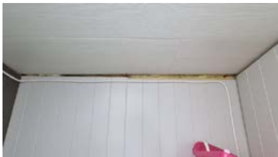
Manglende listverk i overgang vegger og himling i teknisk rom.
