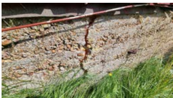
Gjennomgående sprekk i grunnmur mot sør.
