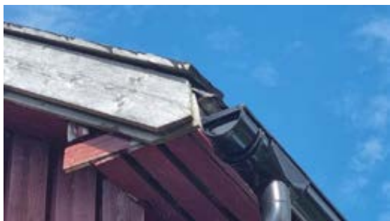
Ufagmessig løsning i overgang vindskibord, renner og raft.
