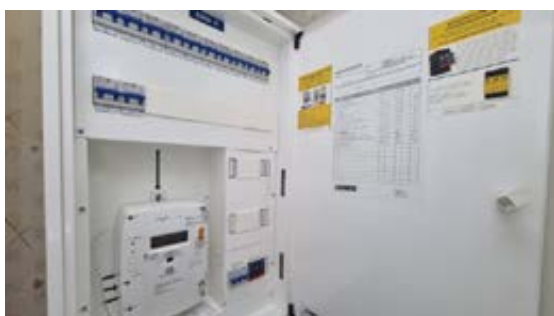
Kontroll av el-skapet.
