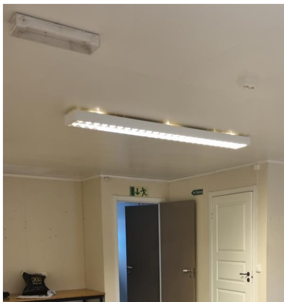
Bilde 34: Lysarmatur med lysstoffrør.
