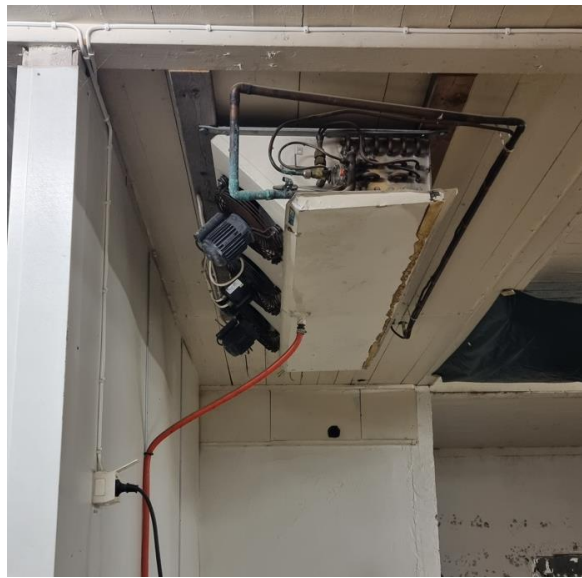
Bilde 25: B1, 1.etg, rom 7. Kjølemaskin.
