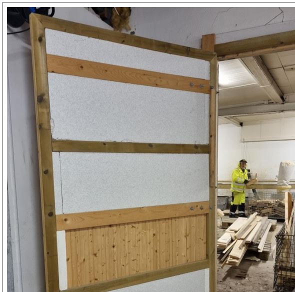
Bilde 19: Isopor i dør, B1, 1. etg. rom 6.
