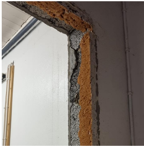
Bilde 27: B1, 1.etg, vindfang. Fugeskum.
