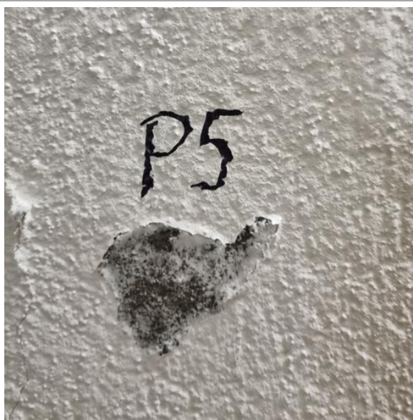
Bilde 10: B1, rom 5, P5, maling på vegg.
