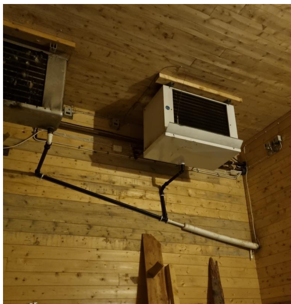
Bilde 21: B1, 1. etg. fryserom, kjølemaskiner.
