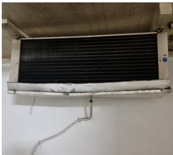
Bilde 23: B1, 1. etg, rom 5. Kjølemaskin.
