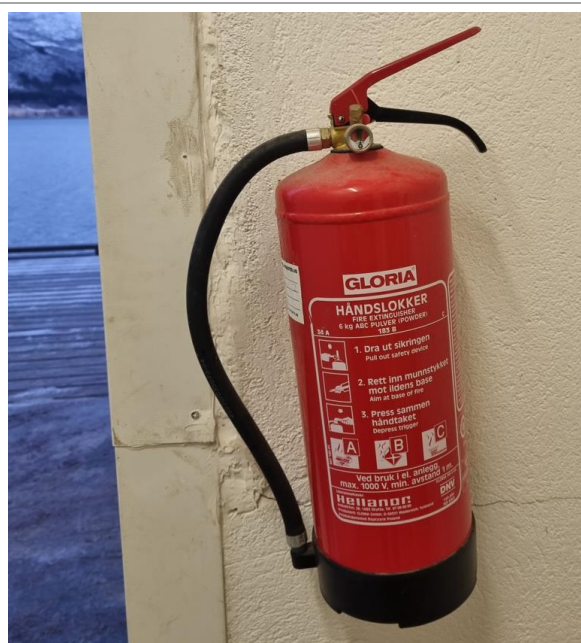
Bilde 28: B1, 1. etg, vindfang. Brannslukker, pulver.
