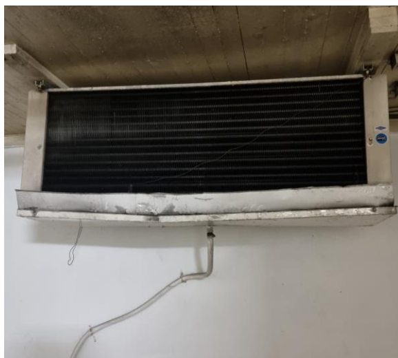
Bilde 23: B1, 1. etg, rom 5. Kjølemaskin.
