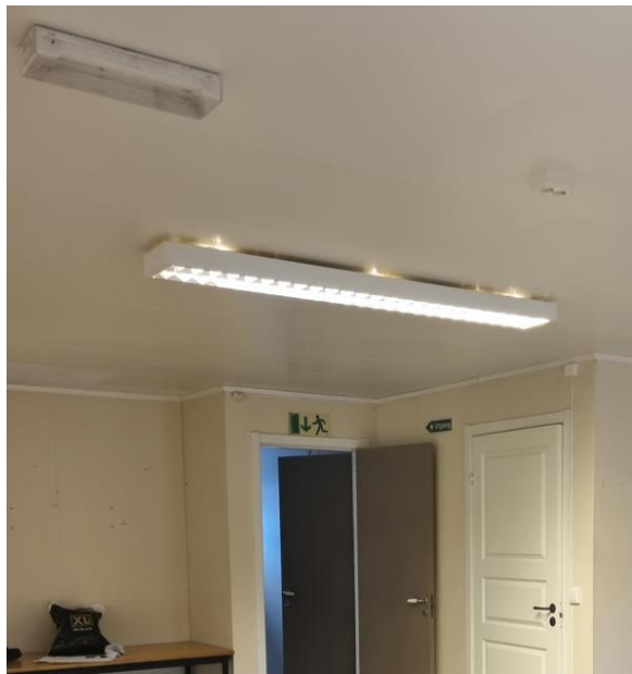
Bilde 34: Lysarmatur med lysstoffrør.
