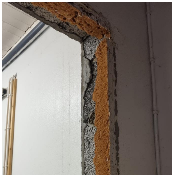
Bilde 27: B1, 1.etg, vindfang. Fugeskum.
