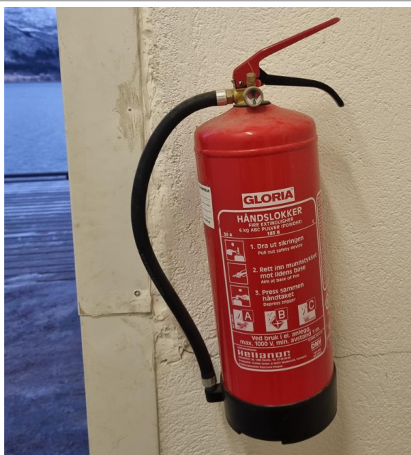
Bilde 28: B1, 1. etg, vindfang. Brannslukker, pulver.
