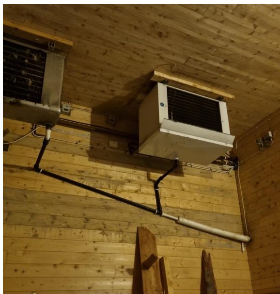
Bilde 21: B1, 1. etg. fryserom, kjølemaskiner.
