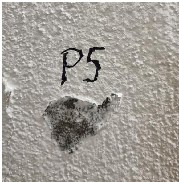
Bilde 10: B1, rom 5, P5, maling på vegg.
