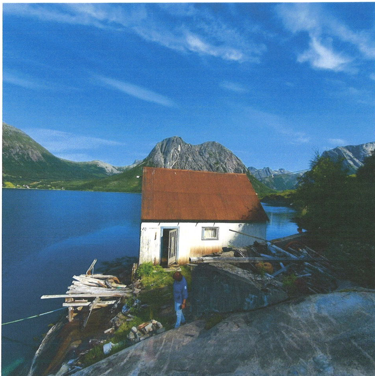
Ishuset med nedfallen kai, bilde tatt fra sør.
